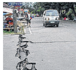
Ein Riss spaltet eine Straße im Zentrum der Philippinen. Foto: rtr
